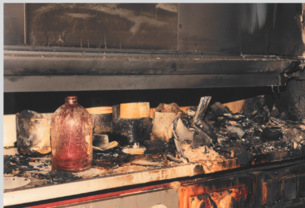
Zuurkast met gebarsten flessen met (verbrande) chemicaliën.
